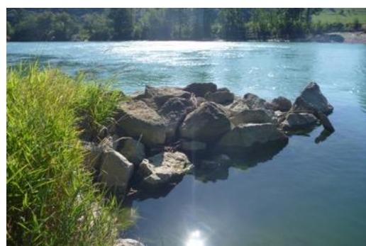
Figure 63 : Épi en enrochement (Aar à Kallnach).
