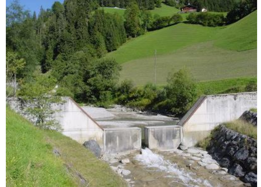
Figure 154 : Ouvrage de rétention des matériaux charriés, dépotoir à alluvions (Narrenbach à Zwischenflüh).
