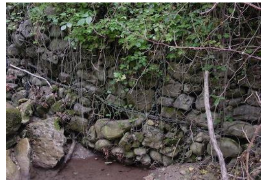
Figure 81 : Gabion ; état : mauvais (Hältetlibach à Guggisberg).
