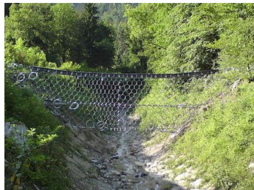
Figure 160 : Filet de retenue pour les laves torrentielles Geobruigg VX, VX140-H4 (Trachtbach à Brienz).
