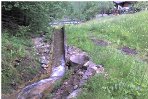
Figure 12 : Cunette en béton (Jungsgraben à Walki).
