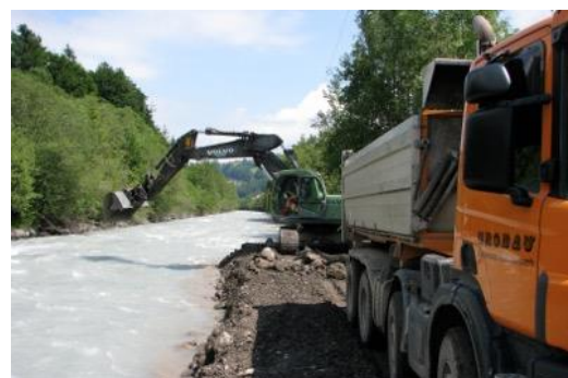
Figure 144 : Apport de gravier destiné à stabiliser le lit sur un site de déversement de matériaux charriés (Kander à Reichenbach).
