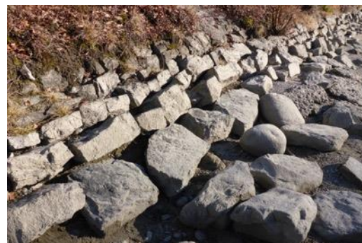
Figure 53 : Pavage (Aar à Muri, Berne) ; l'état de ce pavage est mauvais, voire alarmant.
