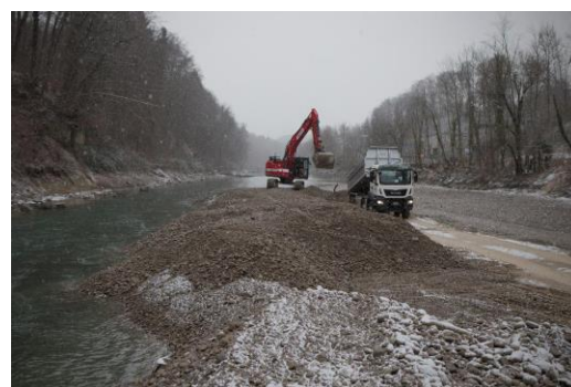
Figure 145 : Site de déversement de matériaux charriés à fonction principalement écologique (Aar à Tiefenau, OPC 2017).
