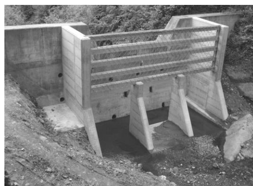
Figure 163 : Ouvrage de rétention des matériaux charriés et de bois flottant, cloison siphonoïde (Bitzighoferbach ; source : VAW Mitteilung 188, 2006).
