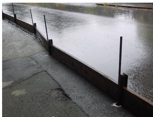
Figure 33 : Mesure mobile, lattes de bois avec rails de guidage (Leusegraben à Wichtrach).
