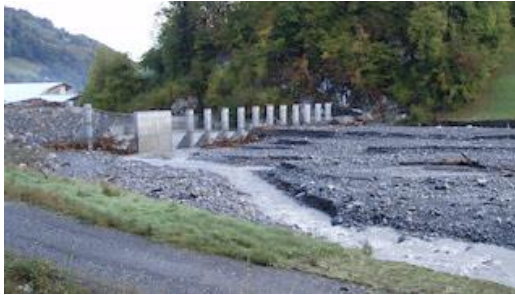
Figure 168 : Ouvrage de rétention de bois flottant, dégrilleur (Chiene à Reichenbach i. K., ouvrage de rétention de bois flottant et des matériaux charriés).
