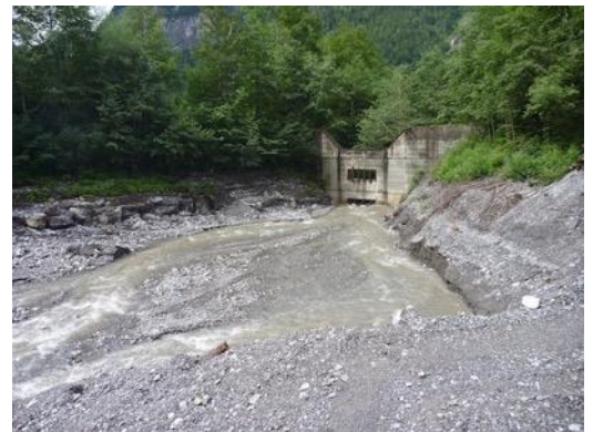
Figure 186 : Ouvrage de rétention des matériaux charriés, dépotoir à alluvions (Stegenbach à Kandergrund).
