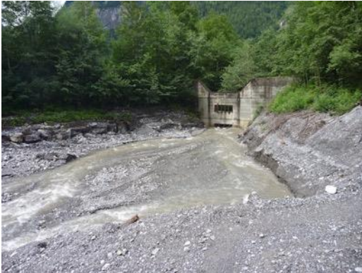
Figure 150 : Ouvrage de rétention des matériaux charriés, dépotoir à alluvions (Stegenbach à Kandergrund).
