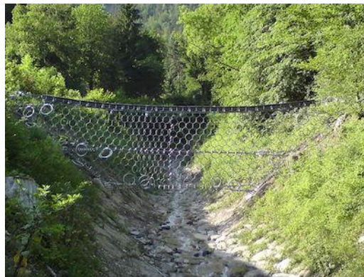
Figure 153 : Ouvrage de rétention des matériaux charriés, filet de retenue pour les laves torrentielles Geobrugg VX, VX140-H4 (Trachtbach à Brienz).
