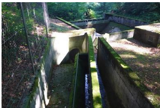
Figure 89 : Ouvrage de prise d'eau faisant office d'ouvrage de décharge (Heubächli à Emmen).
