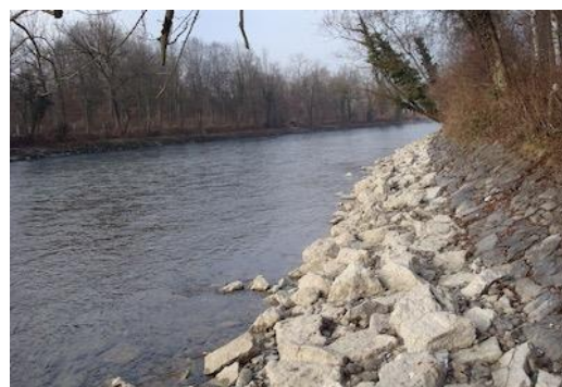
Figure 79 : Butée de pied en enrochement (Aar à Berne).
