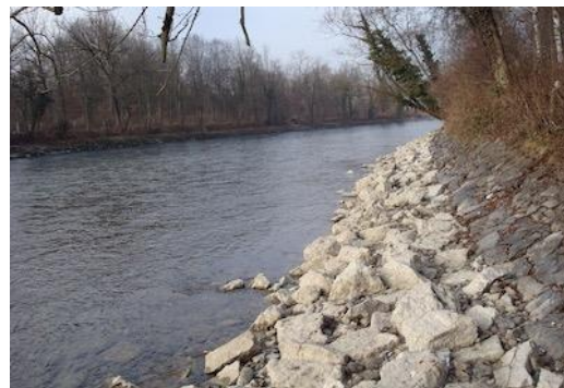
Figure 132 : Butée de pied en enrochement (Aar à Berne).
