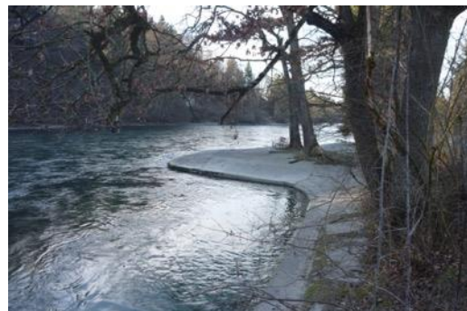
Figure 61 : Épi en béton (Aar à Münsingen).
