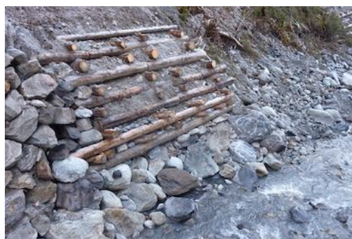
Figure 70 : Caisson en bois protégeant la berge de l'érosion latérale (Schwarze Lütschine à Grindelwald).
