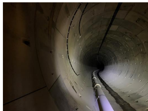
Figure 97 : Galerie d'évacuation des crues de l'Aar à Thoun (OPC 2021).
