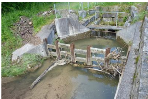
Figure 166 : Ouvrage de rétention de bois flottant (Dorfbach à Küssnacht).
