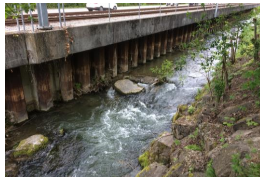
Figure 9 : Rideau de palplanches protégeant de l'érosion latérale le long d'une voie de chemin de fer (Worble, Ittigen. OPC 2021).
