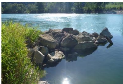
Figure 60 : Épi en enrochement (Aar à Kallnach).
