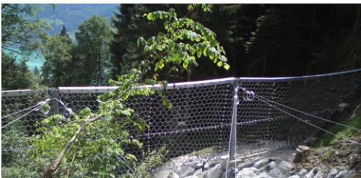
Figure 152 : Ouvrage de rétention des matériaux charriés, filet de retenue pour les laves torrentielles Geobrugg UX, UX-160-H4 (Trachtbach à Brienz).
