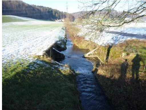
Figure 151 : Ouvrage de rétention des matériaux charriés, dépotoir à alluvions (Önz à Wynigen).
